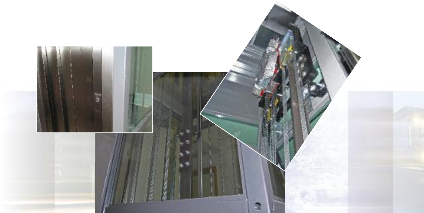
Fahrstuhlanlage Straßburger Straße 23-31
